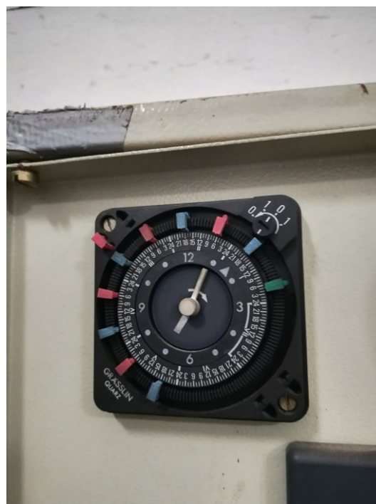
Figura 4.6 – Orologio generale a servizio dell'impianto termico
