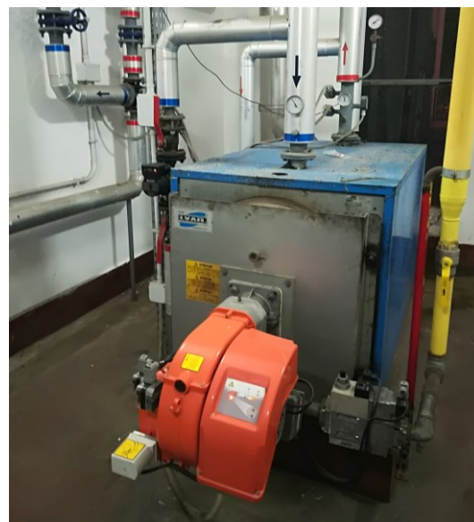
Figura 8.6 - Particolare del generatore di calore attuale
